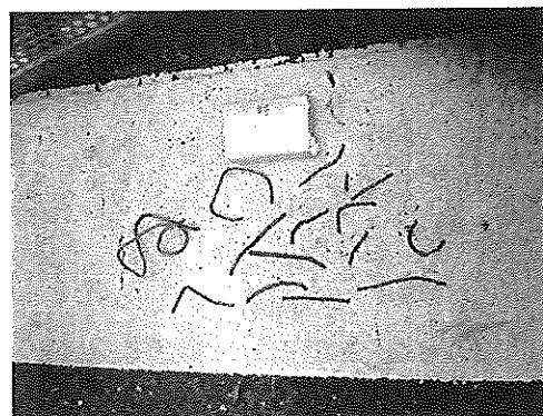
写真-11 破碎されたヒューム管の鉄筋
